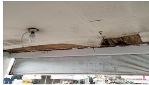
Gambar 2. Kondisi Plafon yang Rusak
