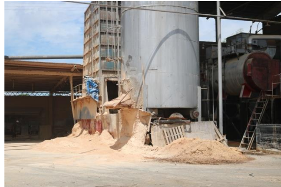
Gambar 2. Debu di Area Boiler
