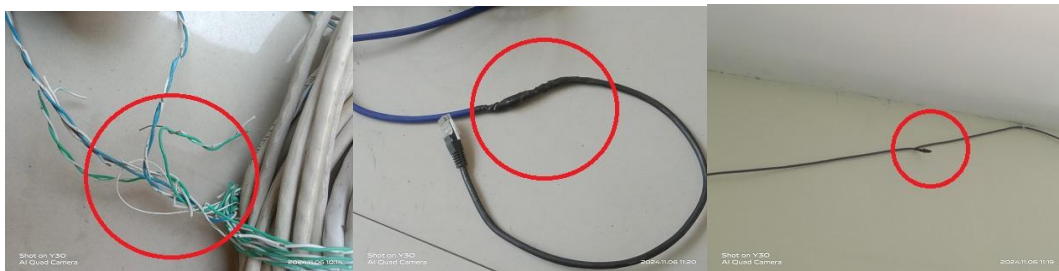
Gambar 1. Kerusakan fisik kabel LAN hasil survei lapangan
