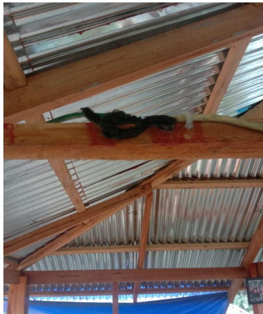
Gambar 9: Instalasi listrik yang kurang baik dengan menggunakan kantong plastik sebagai isolasi disalah satu lokasi survey PKM
