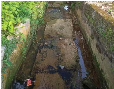
Gambar 5. Dinding Saluran Roboh
