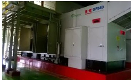
Gbr 1: Penutup Turbin gas Kawasaki GPB80
