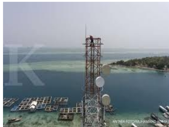
Gambar 2. Menara Bersama Telekomunikasi yang dibangun di area publik. (industri.kontan.co.id)
