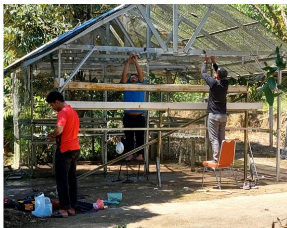
Gambar 4. Proses Instalasi Sistem Penyiraman (Selang dan Nozzle) di Area Pembibitan Balai Penyuluhan Pertanian (BPP) Kecamatan Sijunjung
