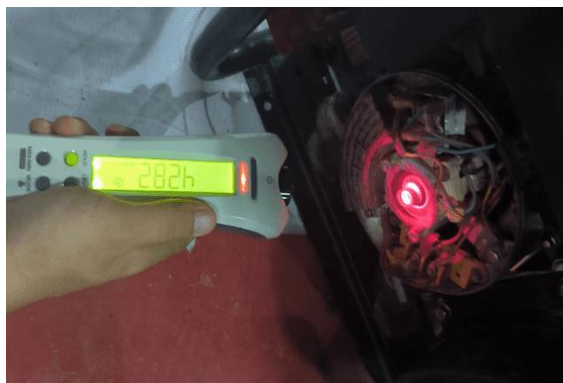
Gambar 3. Pengujian Tanpa Beban Generator set
