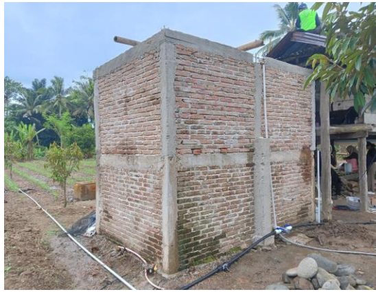
Gambar 3. Bak Penampungan Air
