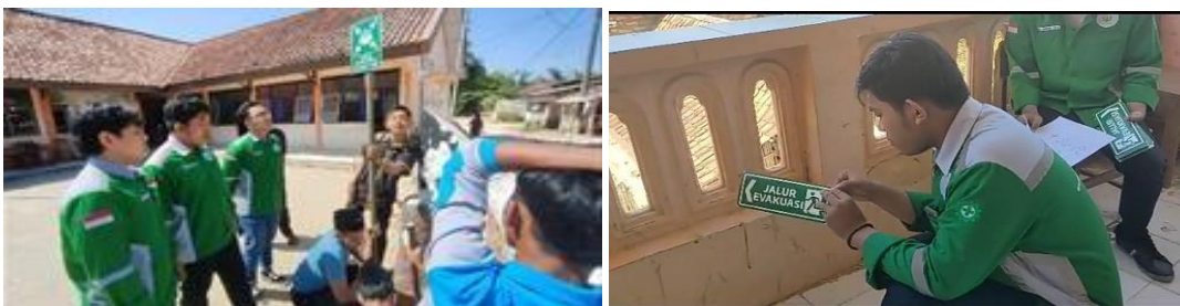
Gambar 4. Pemasangan tanda titik kumpul dan Pemasangan jalur evakuasi
