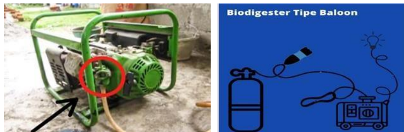
Gambar 8. Gas yang Disalurkan pada Genset diubah menjadi Listrik/ Model Penyaluran tenaga biogas
