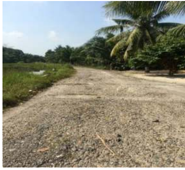
Gambar 5. Kerusakan Gg. Mamutui 4
