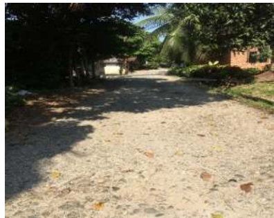
Gambar 1. Kerusakan Jalan Subanglan
