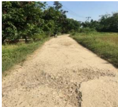
Gambar 10. Kerusakan Jalan Bodi
