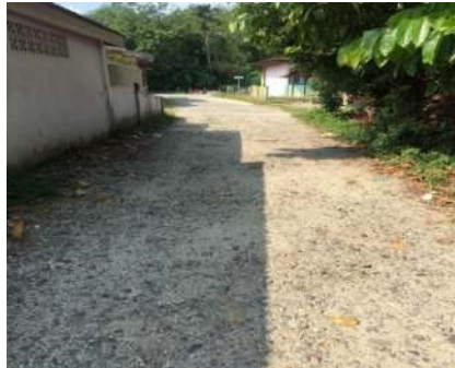
Gambar 3. Kerusakan Jalan Saddam Husein
