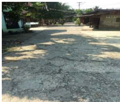
Gambar 2. Kerusakan Jalan Rona
