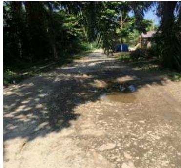
Gambar 6. Kerusakan Jalan Irian
