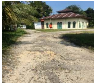
Gambar 4. Kerusakan Gg. Dusun 4
